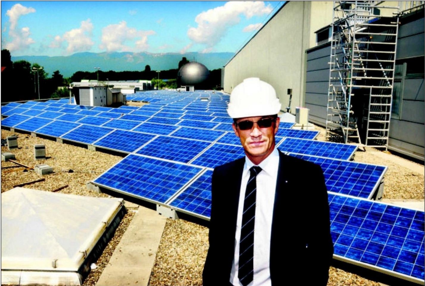
André Hurter, patron des SIG, devant la nouvelle centrale photovoltaïque du Lignon. Cette installation commencera à produire de l'électricité courant juin et sera à sa pleine capacité cet automne. (STEEVE IUNCKER GOMEZ)
